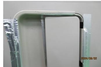
カバー部品のひび割れ
